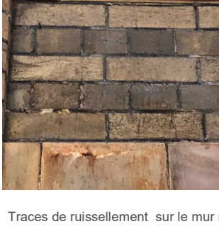
Traces de ruissellement sur le mur nord
