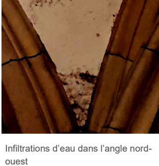
Infiltrations d'eau dans l'angle nord-ouest
