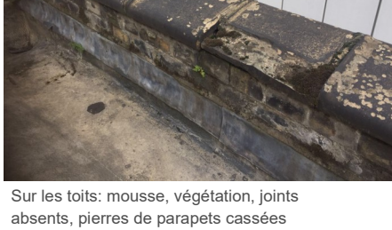
Sur les toits: mousse, végétation, joints absents, pierres de parapets cassées
